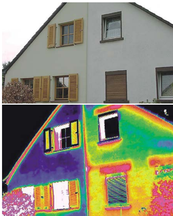
Figura 2 | Immagine termografica di un fabbricato parzialmente ristrutturato. La metà sinistra, con un cappotto termico e serramenti di qualità, mostra un notevole abbattimento delle dispersioni termiche rispetto all'altra metà a destra, non ristrutturata.
