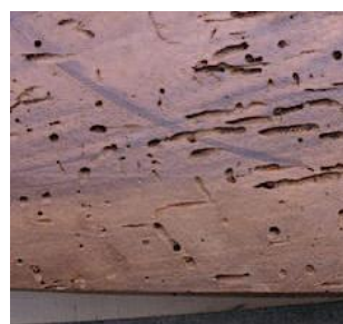
• Trave degradata da insetti (sono visibili i fori di sfarfallamento).
